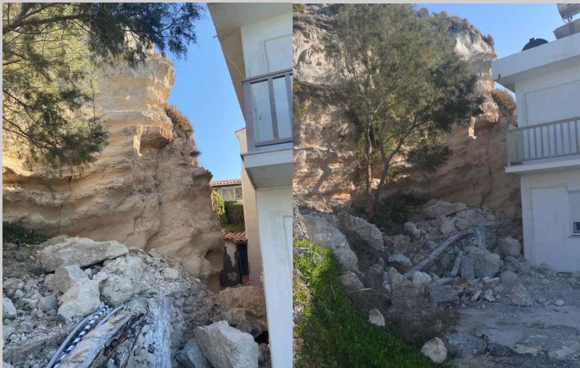
Σχήμα 56: Αποκολλήσεις και καταπτώσεις βράχων στο Κοκκάρι δίπλα σε υφιστάμενα κτίρια. Εμφανής η ύπαρξη κατακόρυφων ρωγμών στο πέτρωμα.
