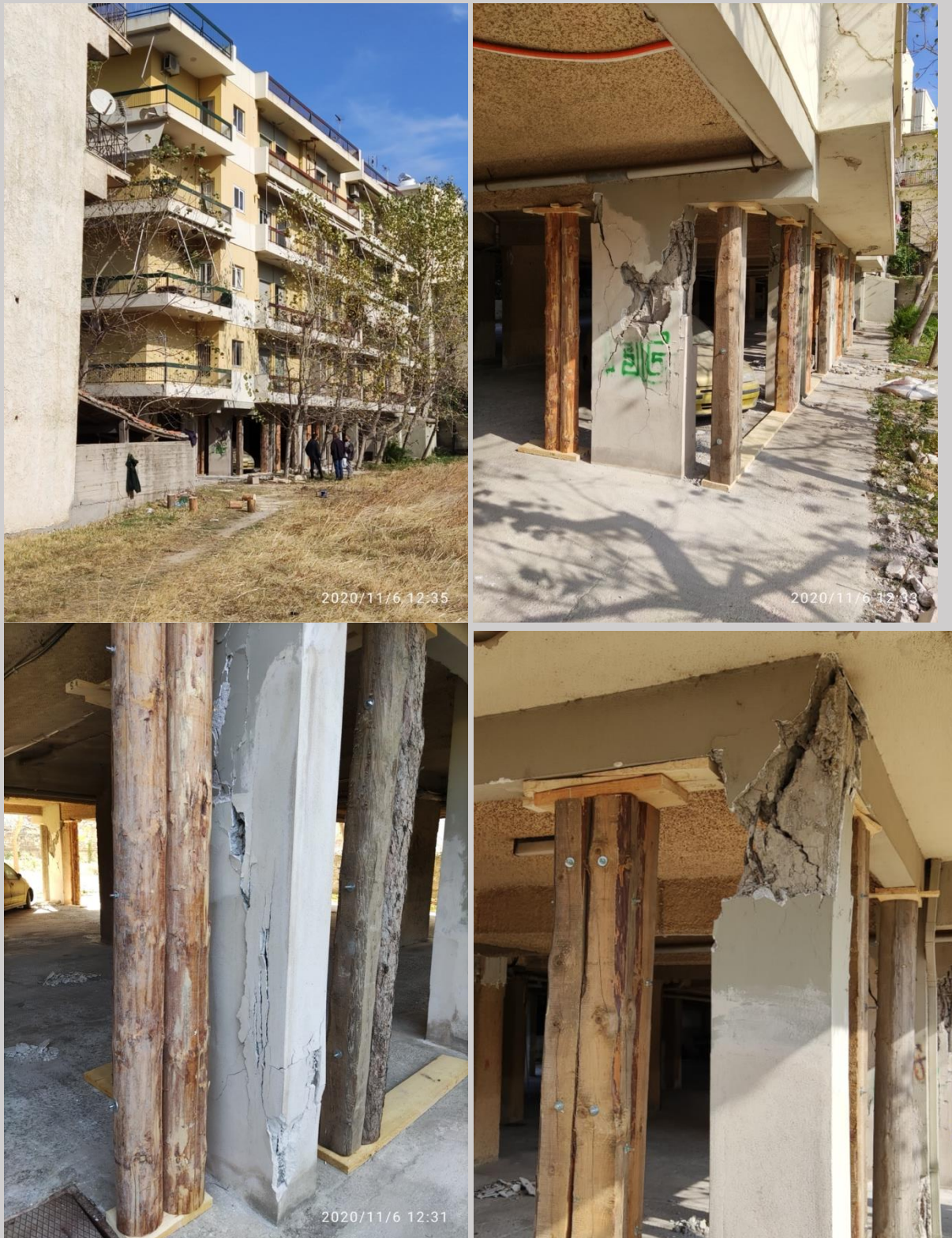
Σχήμα 14: Αστοχία μαλακού ορόφου σε πενταώροφη οικοδομή.
