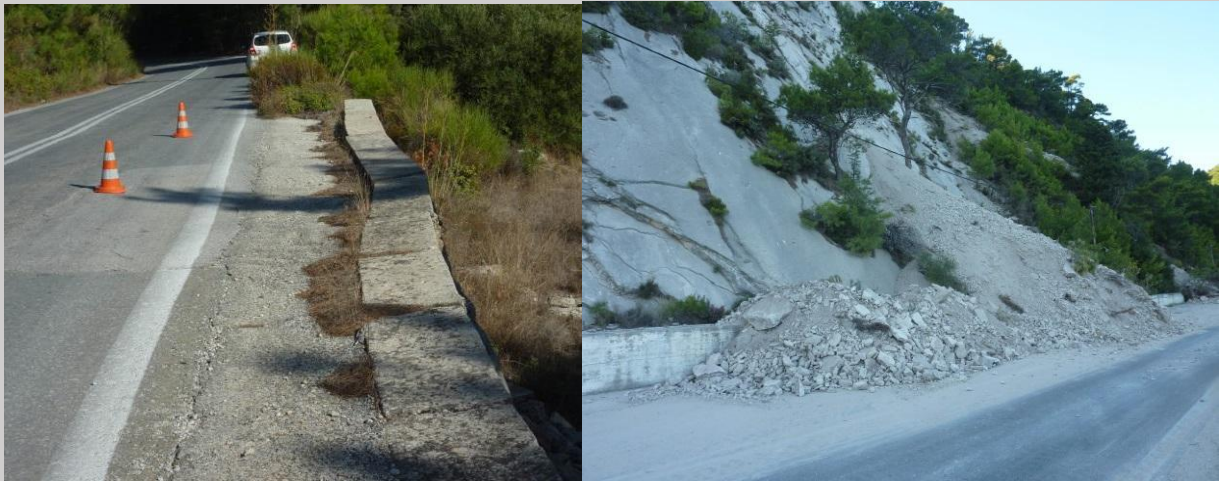
Σχήμα 52: Περιορισμένα τοπικά προβλήματα στο οδικό δίκτυο από μερική αστοχία τοίχου αντιστήριξης κοντά στο χωριό Άγιοι Θεόδωροι και κατολίθωση στα Αυλάκια.
