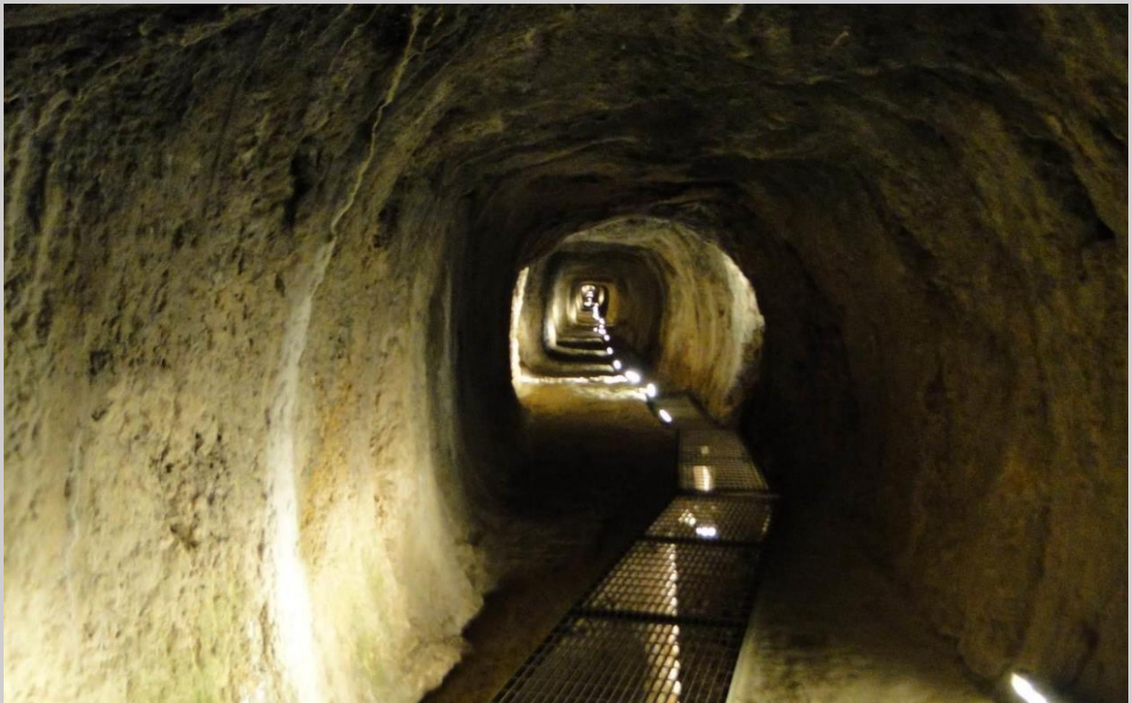
Σχήμα 33: Ευπαλίγειο Όρυγμα. Ελέγχθηκε μέχρι το σημείο 600 μ. (από το βόρειο στόμιο). Δεν παρατηρήθηκαν βλάβες (Χατζηδάκης 2020).
