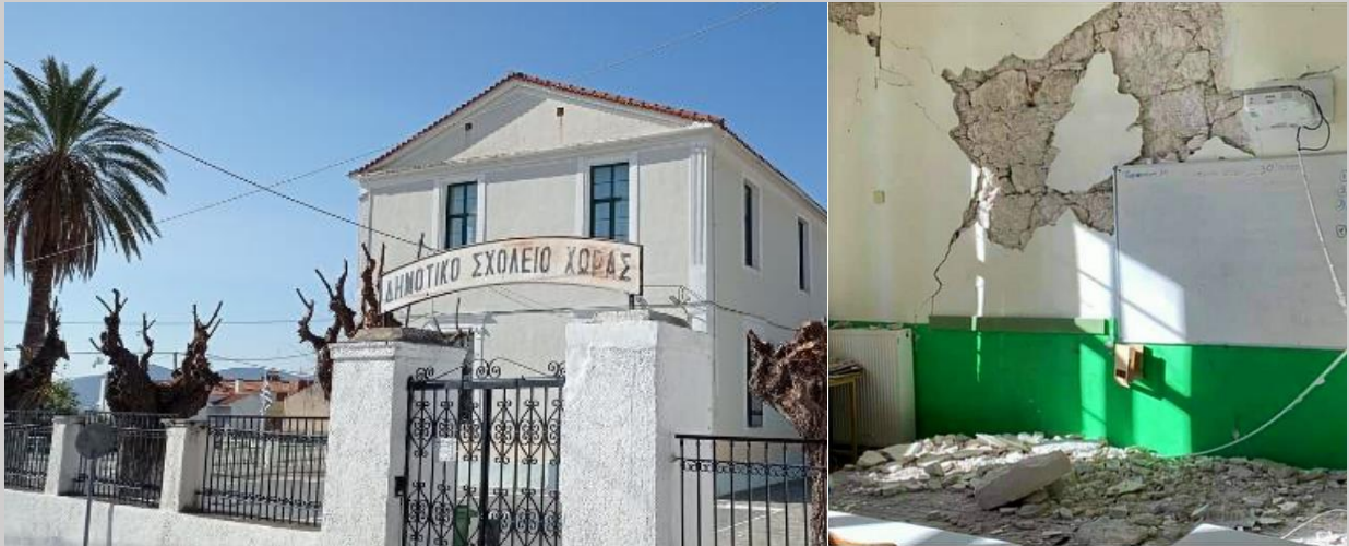
Σχήμα 48: Δημοτικό Σχολείο Χώρας: παρατηρήθηκαν χιαστί διαμητικές ρωγμές στη φέρουσα τοιχοποιία με ταυτόχρονη πτώση επιχρισμάτων.
