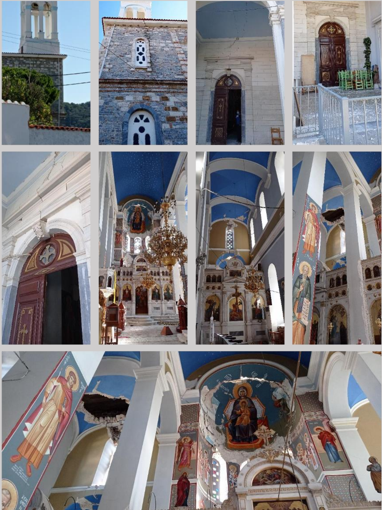
Σχήμα 40: Εκτεταμένες αστοχίες στο εξωτερικό και στο εσωτερικό του Ιερού Ναού Αγίου Νικολάου στο Κοκκάρι, ο οποίος είναι ο μεγαλύτερος Ιερός Ναός της Σάμου. Αστοχία σε αψίδες, στην κλείδα των δύο κεντρικών εισόδων, ρωγμές και πλήρεις αστοχίες σε τρούλους καθώς και βλάβες στο καμπαναριό.
