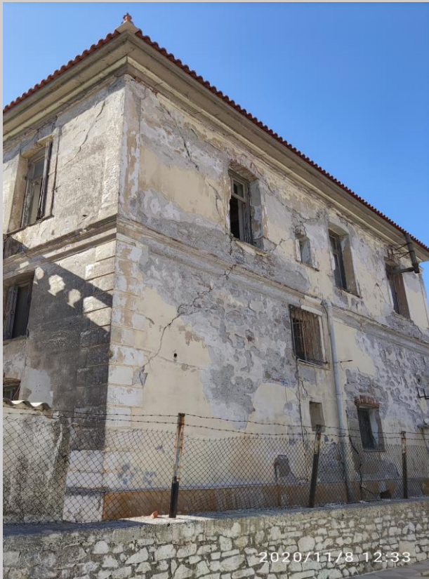
Σχήμα 20: Έντονη διαμητρική ρηγμάτωση στη διεύθυνση του σεισμού
