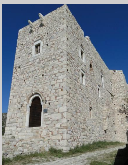
Σχήμα 31: Κάστρο του Λυκούργου Λογοθέτη. Το κτήριο δεν παρουσίασε βλάβες εξωτερικά και συμπεριφέρθηκε ικανοποιητικά καθώς είχε πρόσφατα αποκατασταθεί / ενισχυθεί στατικά. (Χατζηδάκης 2020).
