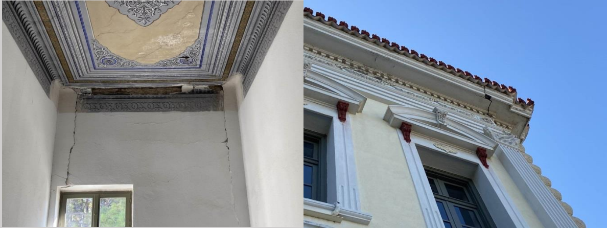
Σχήμα 50: Αστοχία τοίχου εκτός επιπέδου και ρηγμάτωση γωνίας περιμετρικής μαρκίζας στο κτήριο Λυμπέρη του Πανεπιστημίου Αιγαίου.
