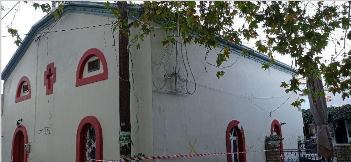
Σχήμα 46: Εκτός επιπέδου αστοχία σε φέρουσα τοιχοποιία στο Ιερός Ναό στην κεντρική πλατεία στους Μυτιληνιούς.
