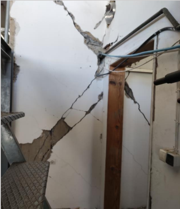
Σχήμα 16: Διατμητική αστοχία σε τοίχωμα μαλακού ορόφου
