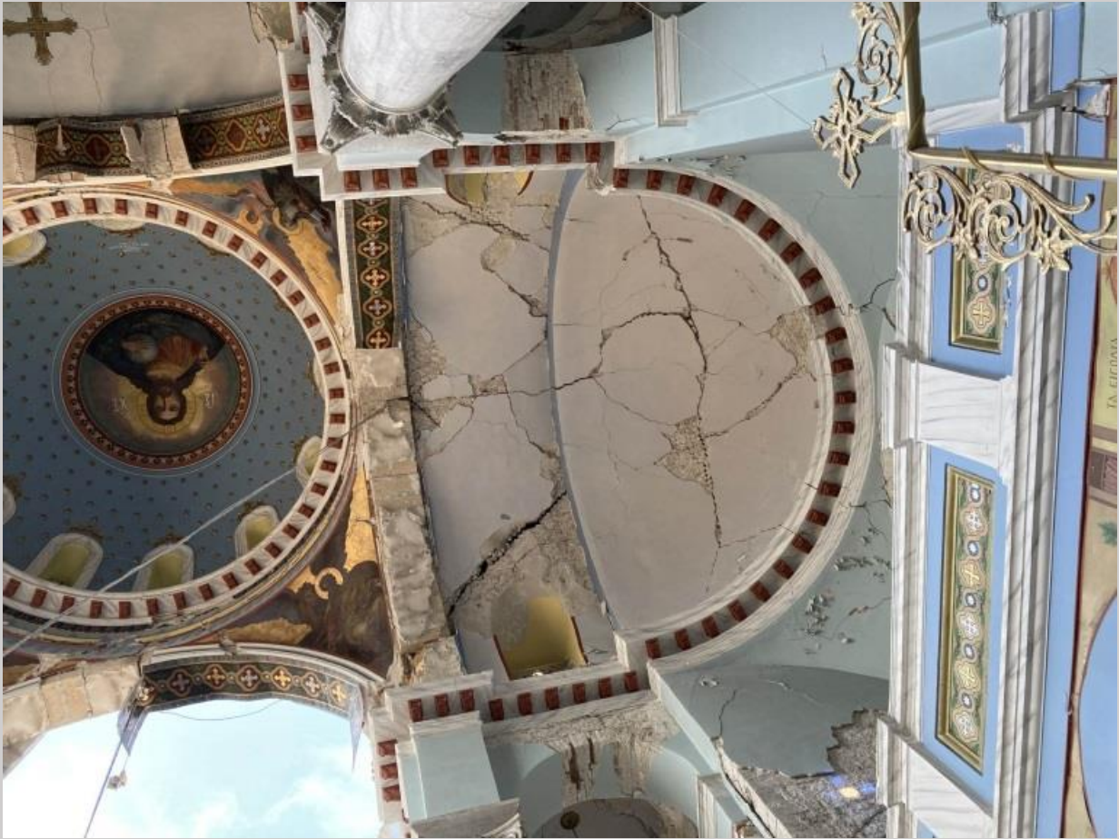
Σχήμα 38: Πτώση της στέγης στη δυτική πλευρά του Ιερού Ναού Κοιμήσεως της Θεοτόκου (Μητρόπολης) στο Καρλόβασι.
