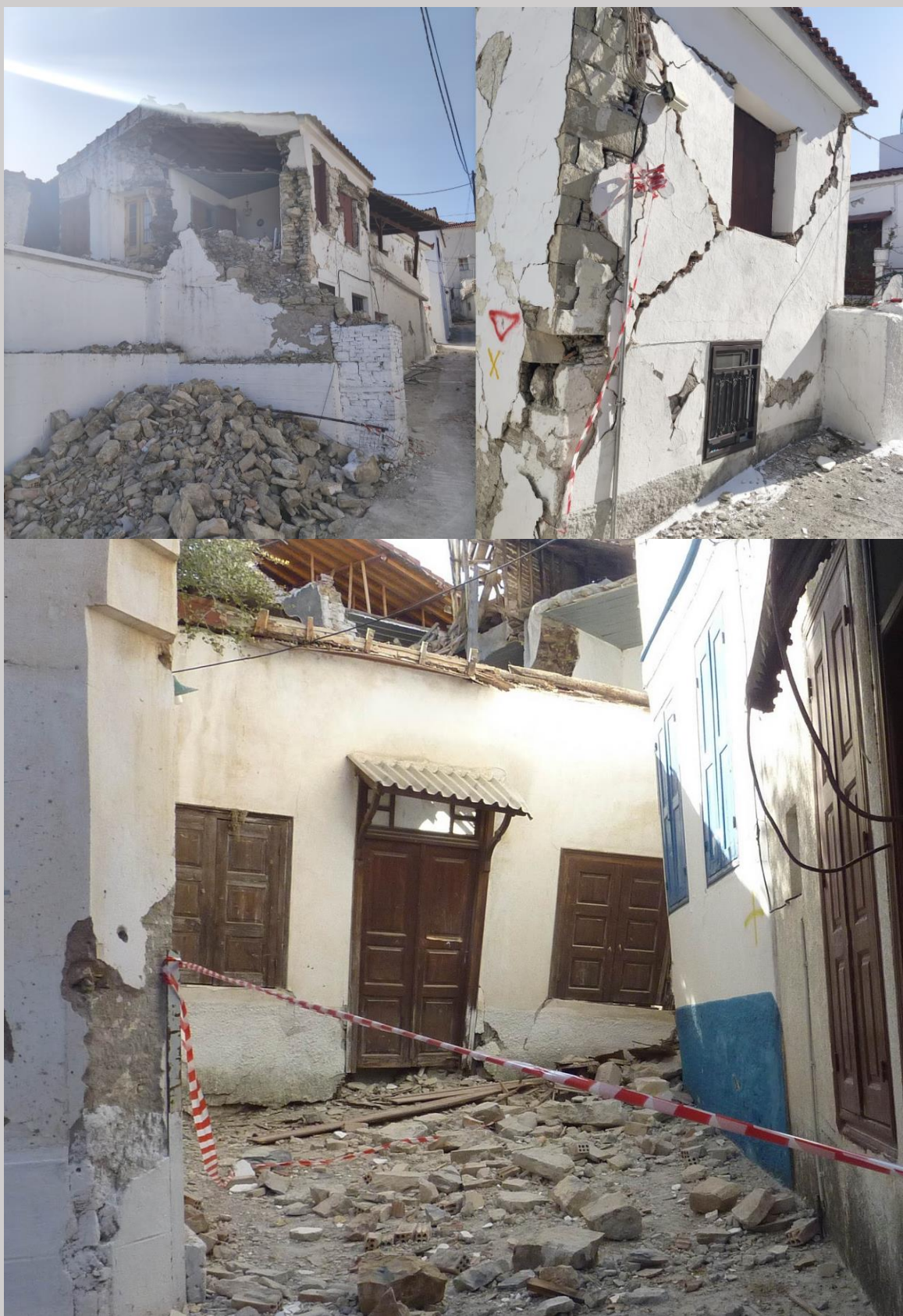
Σχήμα 27: Εντός και εκτός επιπέδου αστοχίες κτηρίων από άσπλη τοιχοποιία.
