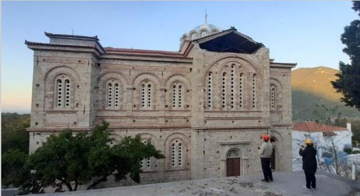
Σχήμα 41: Εκτός επιπέδου αστοχία σε δύο μετώπες κάτω από τη δίριχτη στέγη στον Ιερό Ναό Γενέσιου της Θεοτόκου στα Κονταίικα, η οποία χρονολογείται τον 19 ο αιώνα.
