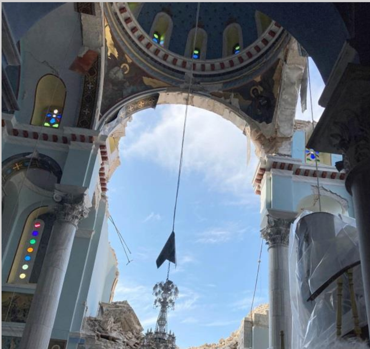
Σχήμα 37: Πτώση της στέγης στη δυτική πλευρά του Ιερού Ναού Κοιμήσεως της Θεοτόκου (Μητρόπολης) στο Καρλόβασι.
