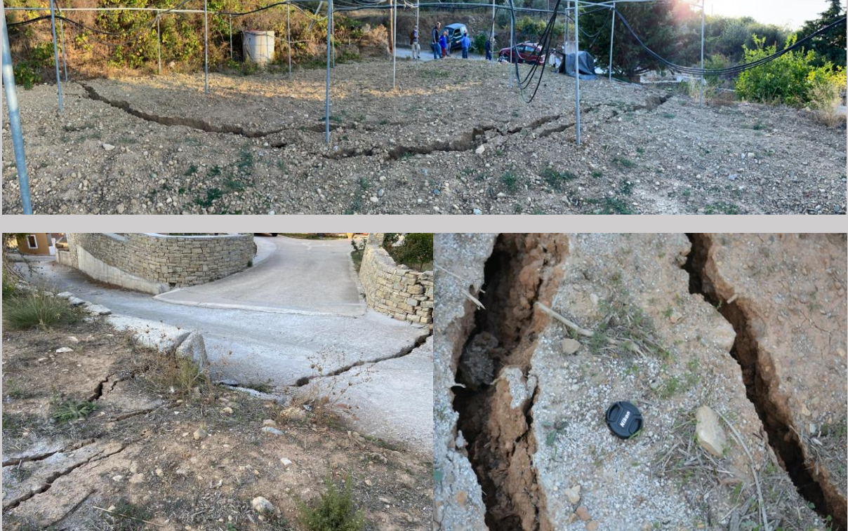
Σχήμα 59: Εκτεταμένες ρωγμές στο έδαφος και στο οδόστρωμα στα Κοντακαίικα, ενδεικτικές μιας ευρύτερης εδαφικής αστάθειας/μετακίνησης στην περιοχή.
