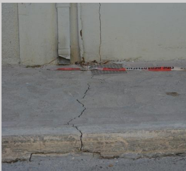
Σχήμα 65: Βλάβες σε κτήρια στο Καρλόβασι λόγω οριζόντιας εξάπλωσης του εδάφους προς το παραλιακό μέτωπο
