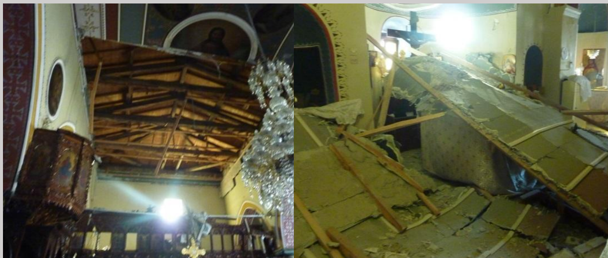
Σχήμα 43: Πτώση ψευδοροφής σε Ιερό Ναό στη Χώρα.
