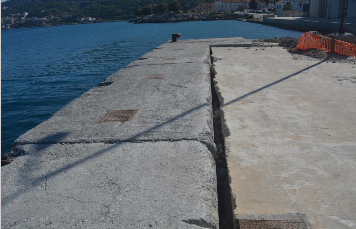
Σχήμα 62: Βλάβες στον ανατολικό λιμένα στο Βαθύ λόγω μετακίνησης και στροφής του κρηπιδότοιχου ή/και δυναμικής συνίζησης της επίχωσης.
