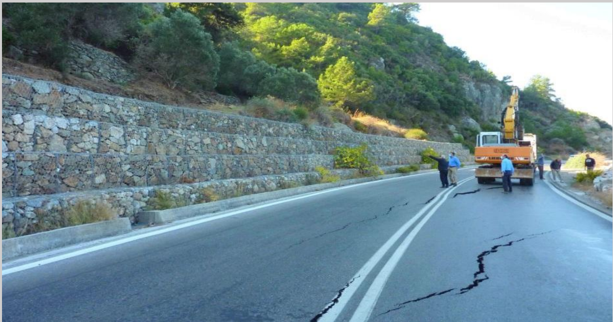
Σχήμα 51: Περιορισμένα τοπικά προβλήματα στο οδικό δίκτυο από ρηγματώσεις λόγω καθίζησης της επίχωσης στην παραλιακή οδό μεταξύ Καρλοβασίου - Βαθέος.
