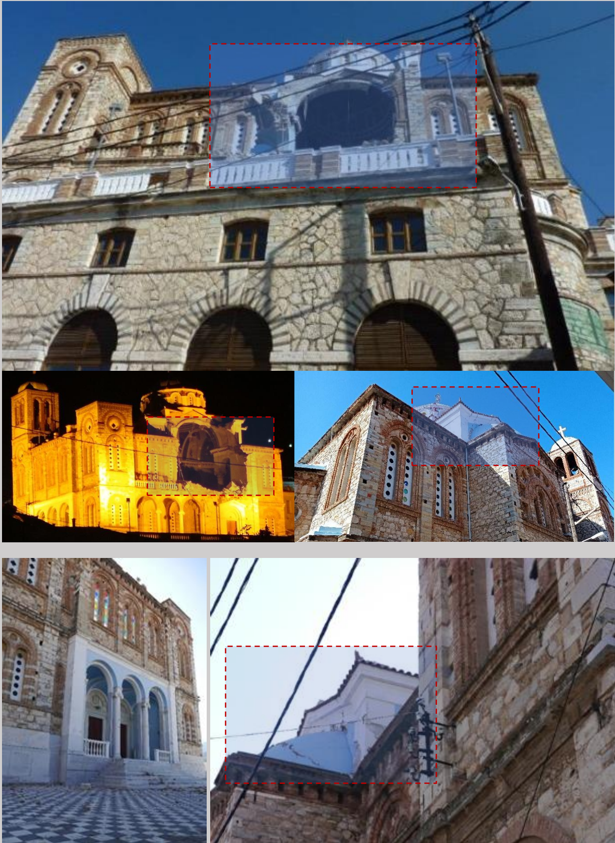
Σχήμα 36: Εκτός επιπέδου αστοχία του νότιου πλευρικού τοίχου που φέρει τον τρούλο Ιερού Ναού Κοιμήσεως της Θεοτόκου (Μητρόπολης) στο Καρλόβασι. Στον συγκεκριμένο ναό υπήρξε και πτώση της στέγης στη δυτική πλευρά του Ναού.
