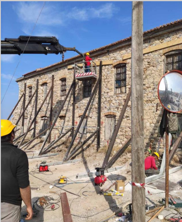
Σχήμα 24: Υποστήριξη τοίχου έναντι αποφυγής περαιτέρω παραμορφώσεων εκτός επιπέδου.
