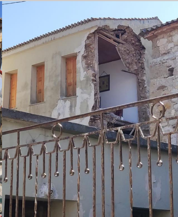
Σχήμα 25: Αποδιοργάνωση τοίχου και αστοχία εκτός επιπέδου
