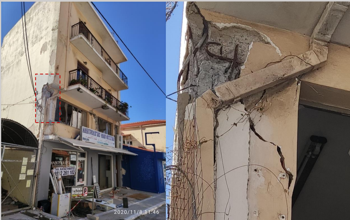
Σχήμα 15: Αστοχία κοντού υποστυλώματος σε τετραώροφη οικοδομή.
