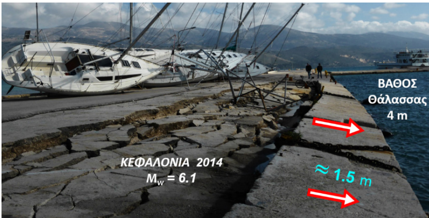
Αστοχία προβλήτα στο Ληξούρι μετά τον διπλό σεισμό ( M 6 και M 6.1) του 2014.
